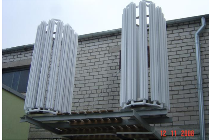
10.10. att. Āra gaisa siltuma sūkņa pasīvie iztvaikotāji pie cūku novietnes sienas (2008).
