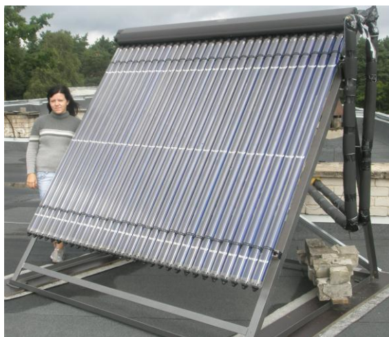
10.6. att. Vakuumcauruļu kolektors uz ēkas jumta Ulbrokā (2008).
